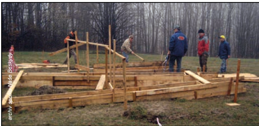
Stavba základů zvoničky. Zleva: Martin Novotný, Drahomír Strnadel, Stanislav Uruba, Marian Žárský, Svatopluk Šmahlík
