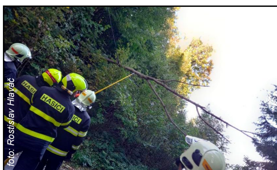
Odstranění spadlého stromu na drátech el. vedení
